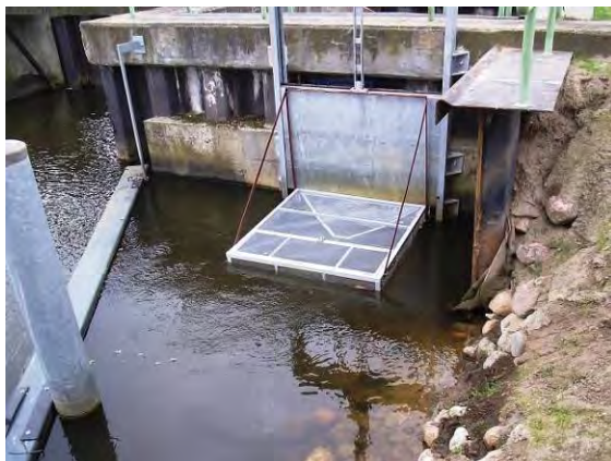
Abb. 20: Dummies aus Effizienzkontrollen an einer Fischaufstiegsanlage (Kastenreue)
