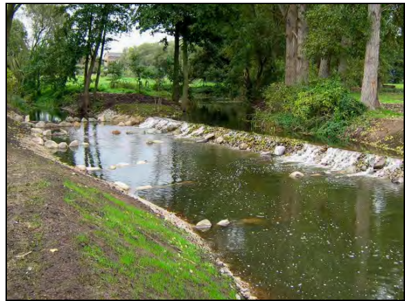
Abb. 50: Auslaufgestaltung bei einer FAA im Umgehungsgerinne; Spundwand zum Hauptgerinne (Wehr) wirkt als Streichwehr und bewirkt Auffächerung der Strömung im Hauptgerinne (auf Foto NW-Fall nach Krautung)
