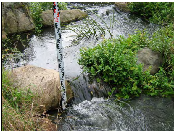
Abb. 47: Raugerinne-Beckenpass mit Engstelle durch ungenaue Bauausführung der Steinriegel, örtliche Höhendifferenz ca. 35 cm
