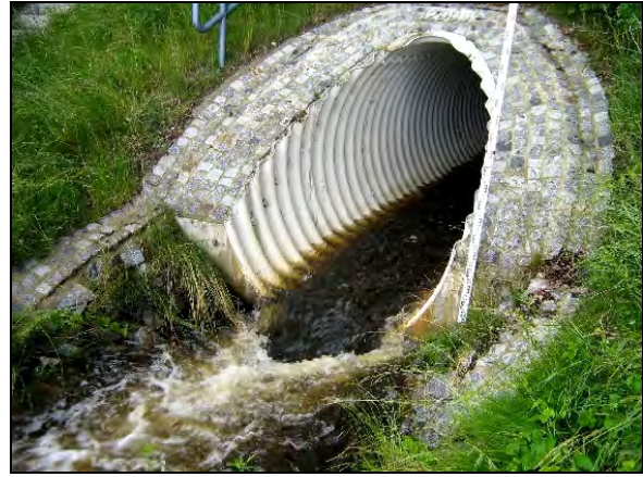
Abb. 4: Erneueres Durchlassbauwerk im Karower Mühlbach mit zu hoher Sohlage und fehlendem Sohlsubstrat
