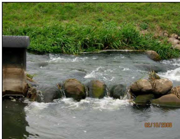
Abb. 48: Nachträgliche Verlängerung einer FAA (Raugerinne-Beckenpass in einem Wehrfeld) aufgrund zu niedriger UW-Stände
