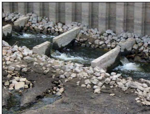
Abb. 22: Zustand vor der Instandsetzung bei Außenniedrigwasser (Elbe); durch seitliche Wasserverluste sinkt der Beckenwasserstand soweit ab, dass die Passierbarkeit der Kronenausschnitte stark eingeschränkt ist
